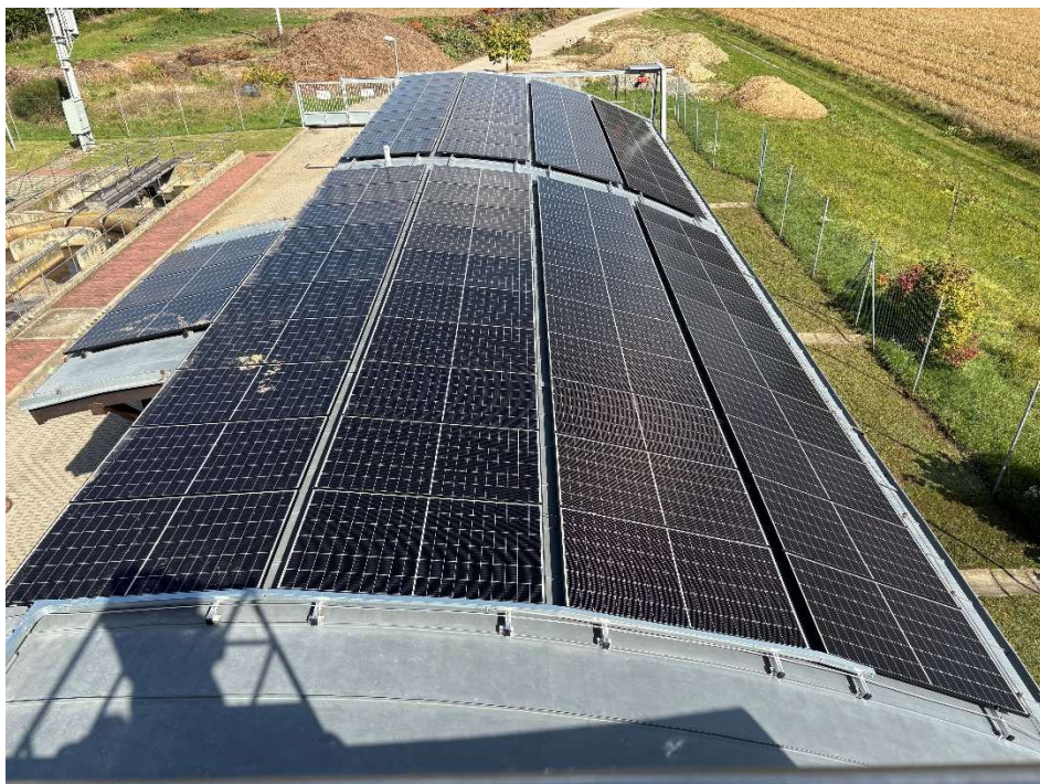
Solární panely na čistírně odpadních vod
